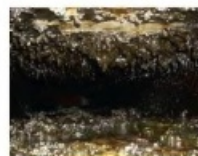
Вентиляционный канал с жировым налетом – прямая опасность к возгоранию
